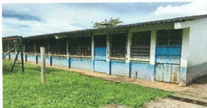
Foto 2: Mantenimiento de 6 puertas y balcones de dos aulas, dirección, biblioteca y bodega. De igual forma se necesita pintura interior y exterior de los mismos módulos.
