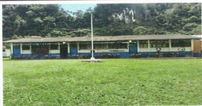
Foto 1: Se ve la necesidad de cambiar el techo de duralita por lámina troquelada de dos aulas juntamente con la dirección, biblioteca y bodega. Asimismo cambio de estructura de hierro corrugado por estructura metálica.
