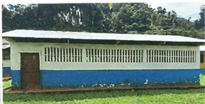
Foto 3: Se necesita la sustitución de 6 balcones de madera por balcones de hierro en el aula de cuarto primaria. Sustitución de estructura de soporte de madera por metal. Sustitución de lámina acanalada por lámina troquelada.
